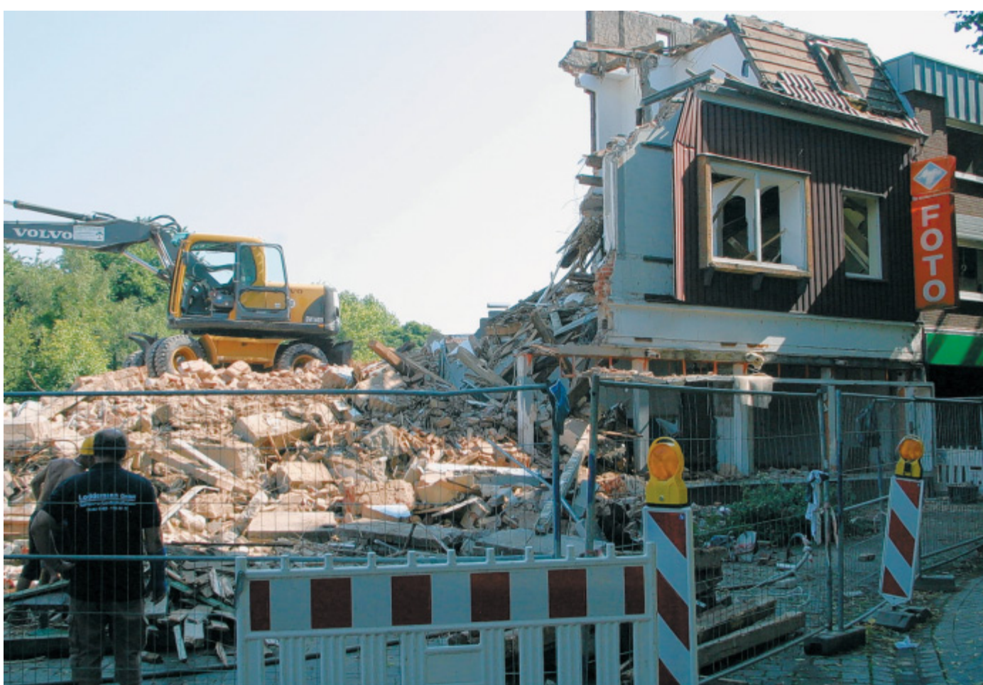
Abriß: Das ehemalige Geschäftshaus J. H. Jäger am Kirchplatz wurde in der vergangenen Woche vom heimischen Unternehmen Loddemann dem Erdboden gleichgemacht. FOTOS: JOE CUBICK
