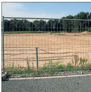
Baustart für den neuen Bauhof an der Fritz-Wallmeier-Straße soll am 3. August sein.
